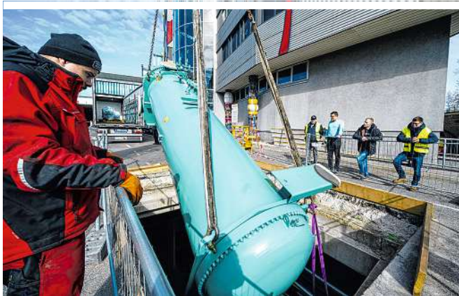
Wien Energie investiert 65 Millionen Euro in das Fernkältenetz
